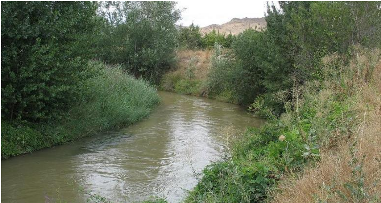
Figura 32-23. Defensa de margen en el río Jalón aguas abajo de la localidad de Saviñán.
