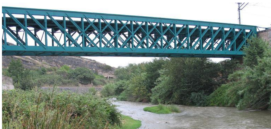
Figura 32-26. Línea de ferrocarril sobre el río Jalón en las inmediaciones de Ricla.
