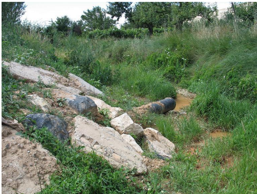
Figura 32-40. Defensa de margen y vertido en las inmediaciones de la localidad de Miedes.
