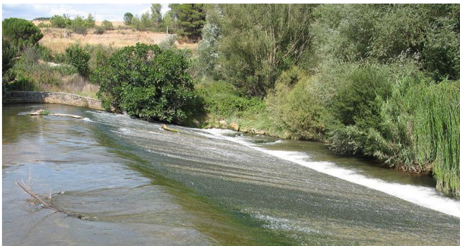
Figura 32-16. Azud en el río Jalón aguas abajo de la localidad de Ateca.
