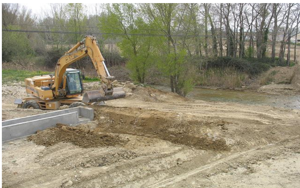
Figura 20-24. Obras en cauce y ribera en las inmediaciones del núcleo de Erla.
