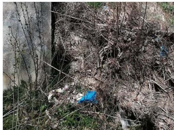
Restos de crecida anterior en las orillas del río. Aliviadero aguas arriba.
