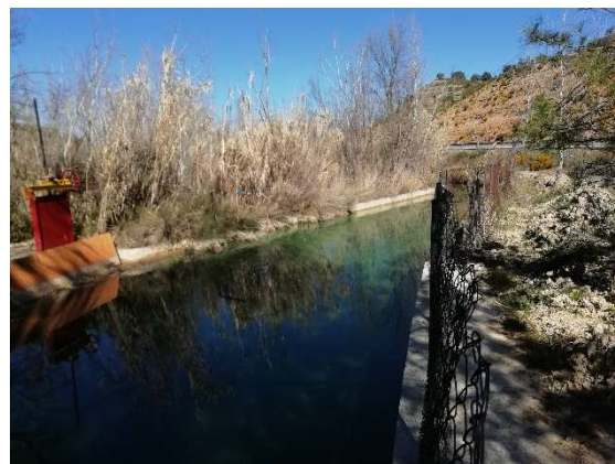
Balsa de entrada a la C.H. con la compuerta cerrada.
