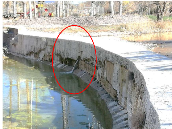
Azud del Rasal totalmente seco, el caudal que circula aguas abajo es que sale por el desagüe (círculo rojo) de la pared del azud.
