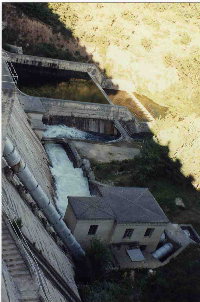
Foto nº 117 Desagüe presa de Ortigosa. Instalación para central hidroeléctrica en espera.
